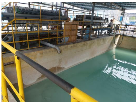
废水处理设施
